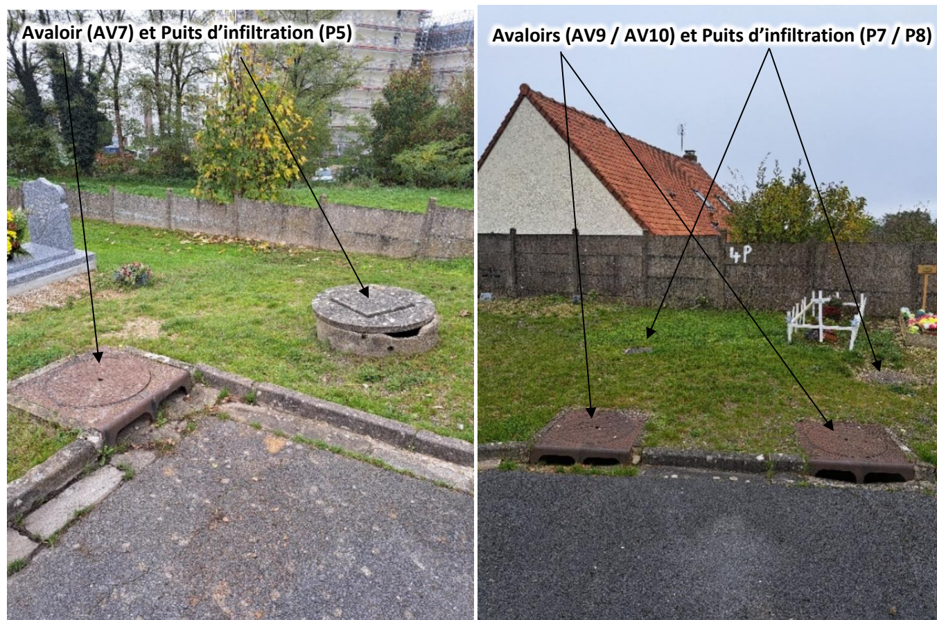
Figure 4 : Puits d'infiltration et avaloirs du cimetière (source : ECR ENVIRONNEMENT, octobre 2024)
